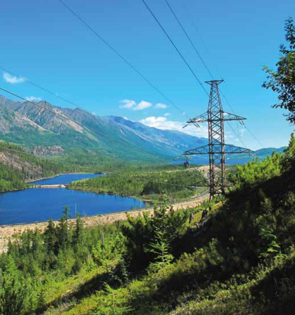
Развитие электросетей ФСК ЕЭС отвечает растущим потребностям Дальнего Востока в электроснабжении
